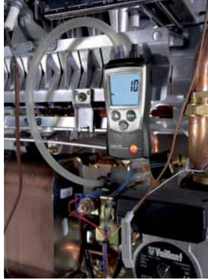
Abb. 9: Ablesen von Gasanschluss- und Düsendruck am testo 510
