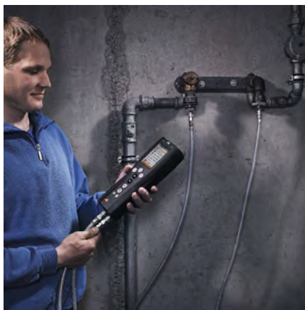
Zkouška provozuschopnosti bez napájecího zařízení
