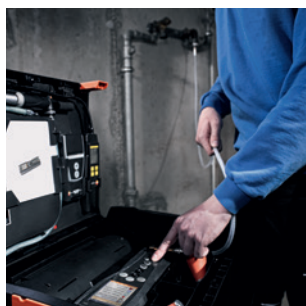
Prueba de estanqueidad automática
