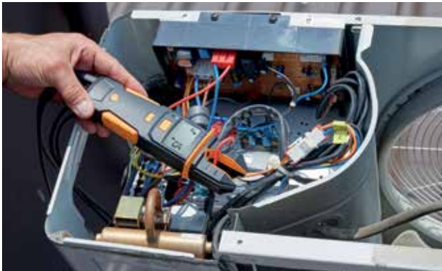
testo 755 ile bir dış soğutma ünitesi üzerinde akım ölçümü
