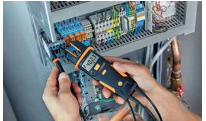
testo 755 ile bir ısı pompası üzerinde gerilim testi
