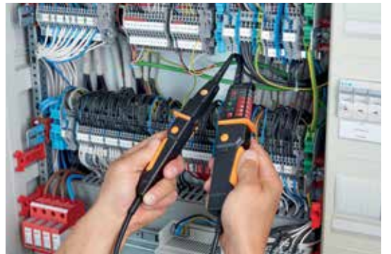
Şalt dolabında gerilim ölçümü
