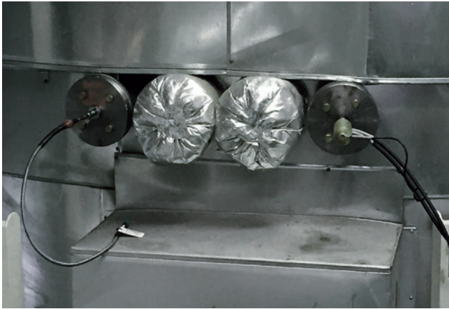
Sonde des testo 350, befestigt an der Mess-Stelle durch Flansch.
