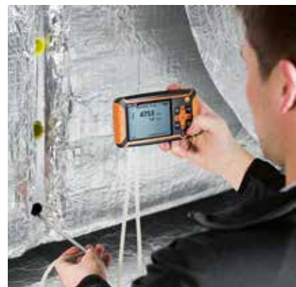
Medición con tubo de Pitot en el canal
