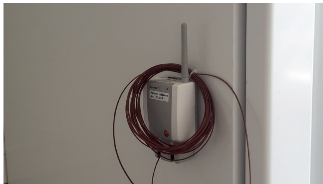
Rádiová sonda testo Saveris T3 na stěně skladu.
