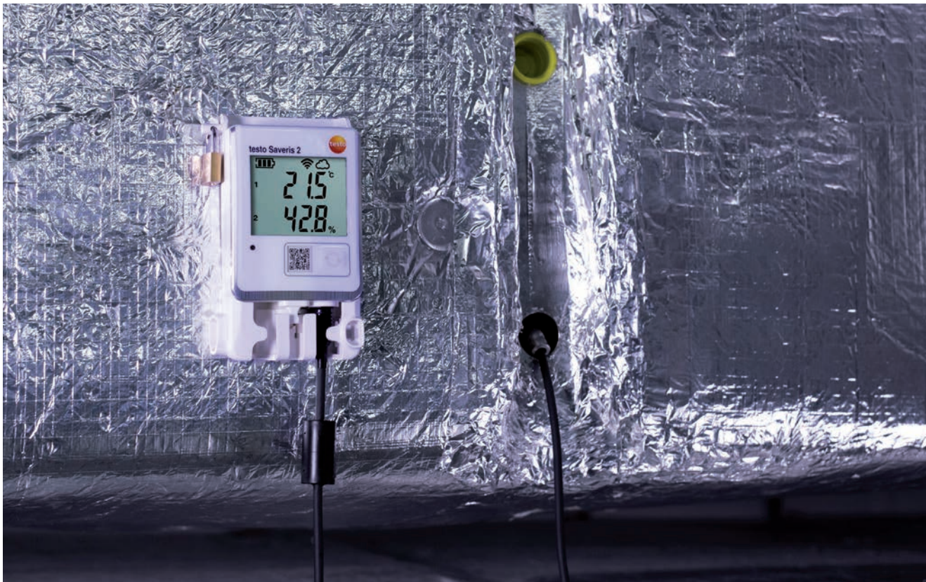
Ein testo Saveris 2-Funkfühler misst Temperatur und Feuchte in einem Lüftungskanal.
