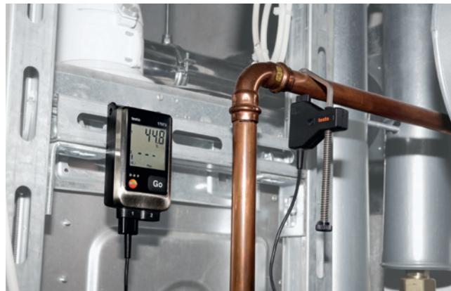
Der Temperatur-Datenlogger testo 175 T3 mit an einer Duschwasserzuleitung angebrachtem Rohranlegefühler.
