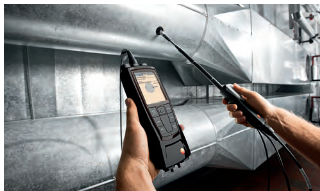
Sonda rychlosti proudění s vyznačenou stupnicí usnadňuje kontrolu hloubky vniku do vzduchotechnického kanálu.
