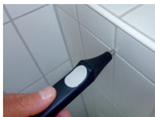
Lokalisierung von Wasserschäden durch dünne Bohrungen.
