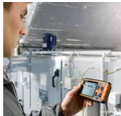
Differenzdruckmessung mit Anschlusschlauch
