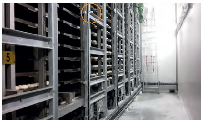
Vývod sondy Saveris T1 ve průběžném skladu zmrazeného pečiva.
