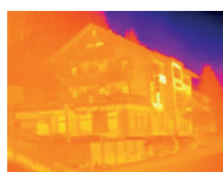
Wärmebild ohne testo ScaleAssist
